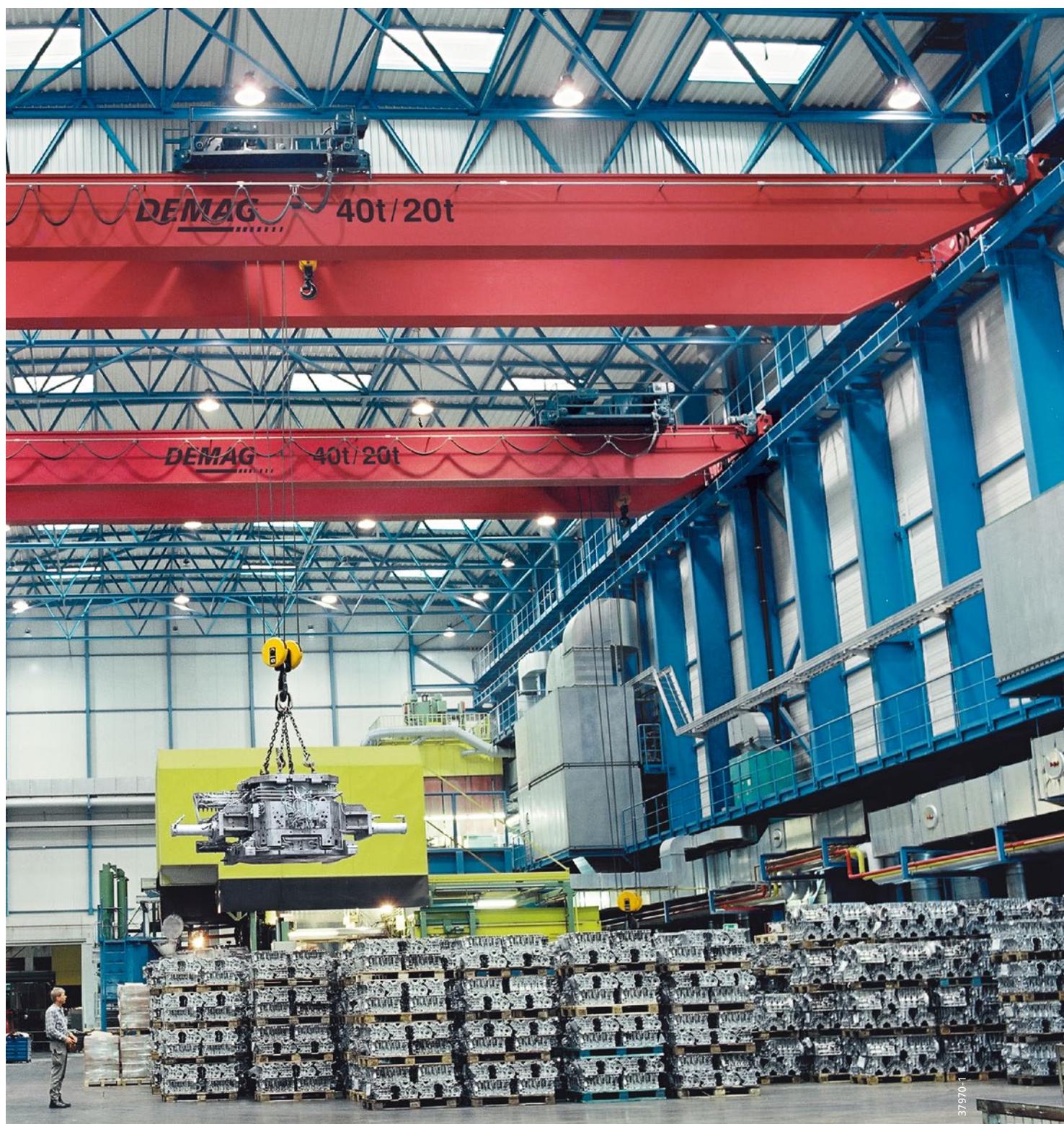
Grúa puente de dos vigas con carros en tándem, para el transporte y volteo de bloques de motores.
